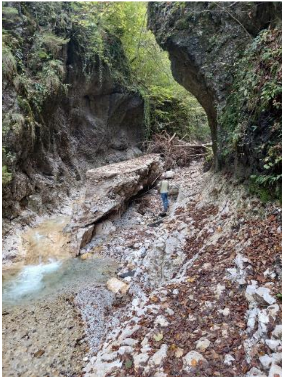
Slika 12: Poškodovana gozdna cesta v Kamniški Bistrici.
